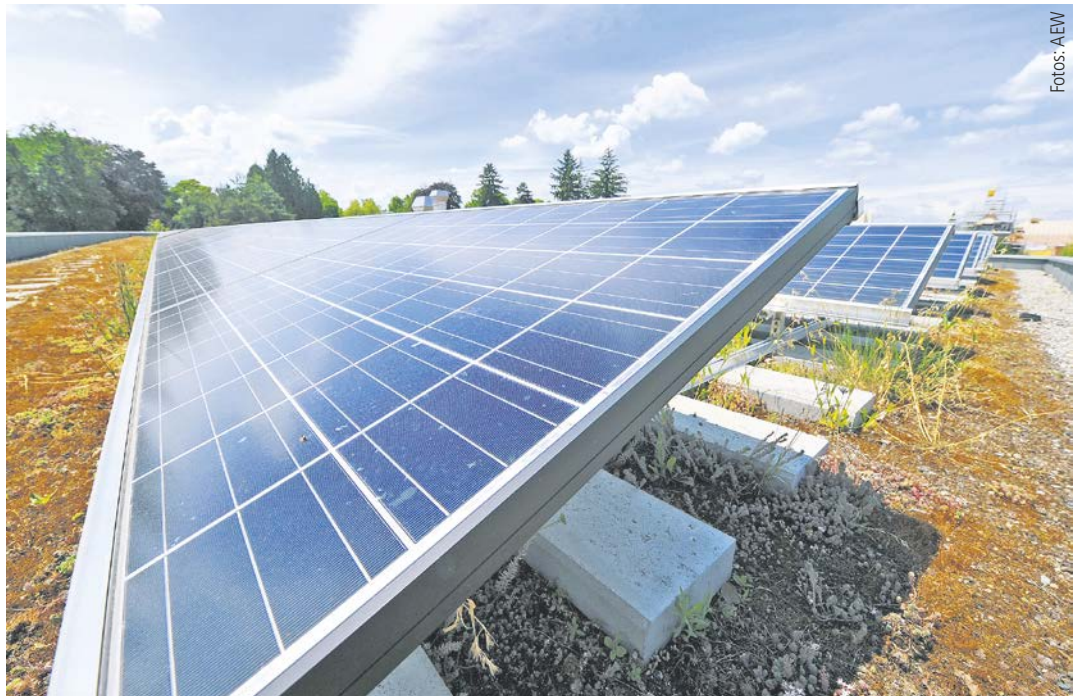
Photovoltaikanlage auf dem Parkhaus des Parkresorts Rheinfelden.
